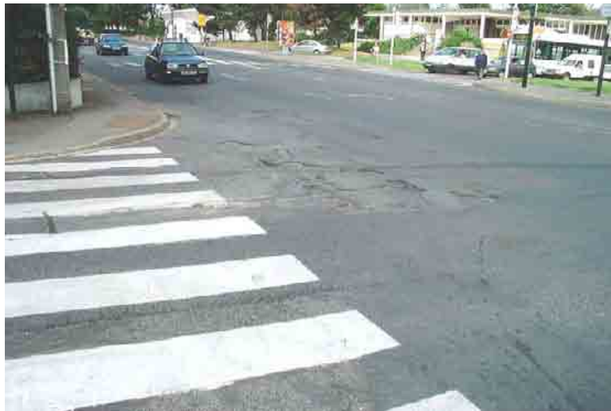
Photo 5 : Situé sur une zone potentielle de virage ou de freinage, cette dégradation de la chaussée peut déstabiliser considérablement le comportement d'un deux-roues.
