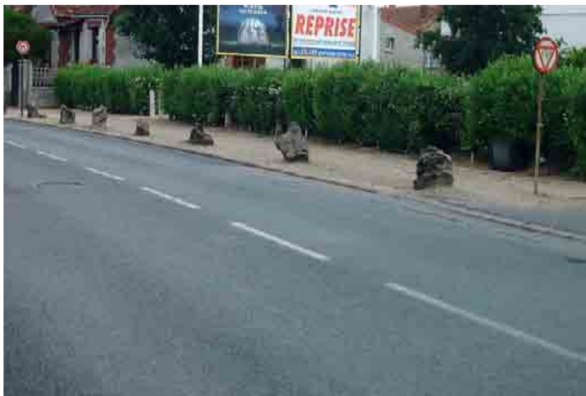
Photo 8 : Ces éléments, prévus pour empêcher les voitures d'utiliser le trottoir comme parking, constituent de par leur forme, leur poids et leur rigidité, des obstacles redoutables pour le motard en cas de chute. Employer ici une bordure suffisamment haute et non agressive constituerait un plus pour la sécurité
