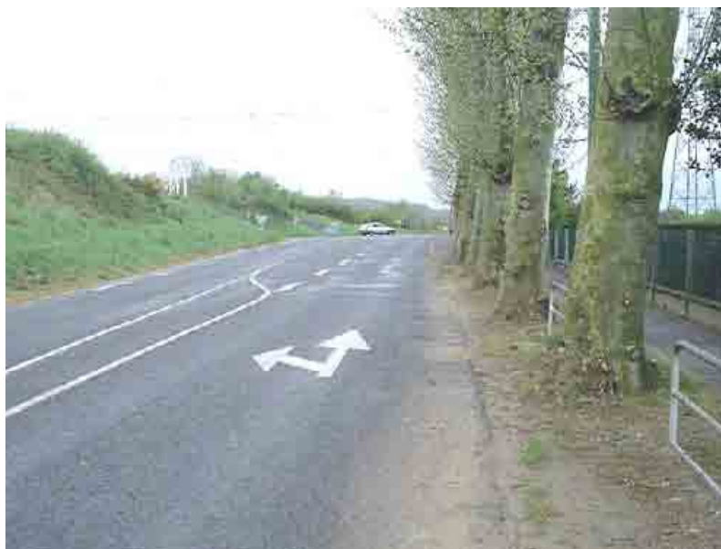
Photo 7 : Ces arbres situés à moins de 1,40 mètres de la chaussée ne peuvent être isolés de façon satisfaisante : leur intérêt environnemental est tel que les aménageurs n'ont pas souhaité leur abattage malgré une dangerosité indéniable. La seule solution serait le déplacement de la chaussée, mais le coût prohibitif d'un tel traitement explique à lui seul cette non-intervention que l'on retrouve sur de nombreux sites aux caractéristiques proches.
