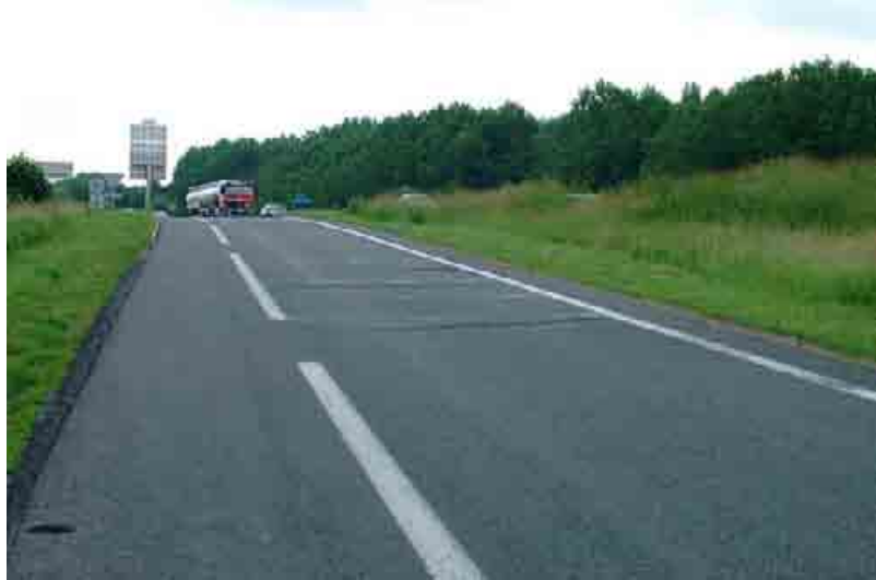
Photo 3 : Cette sortie de 2X2 voies mène directement à un rond-point situé à environ 200 mètres: la nécessité de faire ralentir les usagers de la route est donc indéniable. Pourtant, dans ce cas présent, le motard qui doit passer en quelques dizaines de mètres de 110 à parfois 0 km/h voit sa tâche rendue périlleuse par ces bandes rugueuses particulièrement déstabilisantes lors des phases de freinage.
