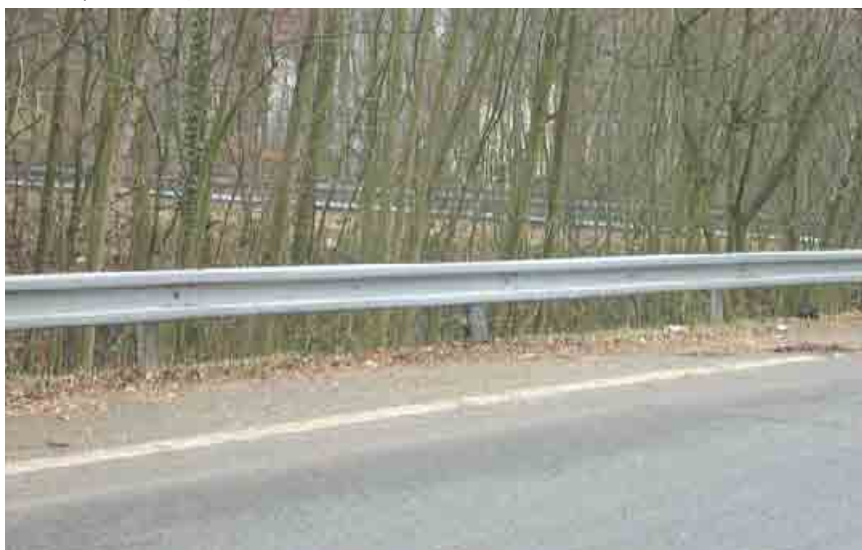
Photo 11 : Le dispositif métallique « de base » ; dans cette configuration, ils jouent pleinement leur rôle de retenue mais leurs supports métalliques constituent pour le motard ayant chuté un très grand risque.
